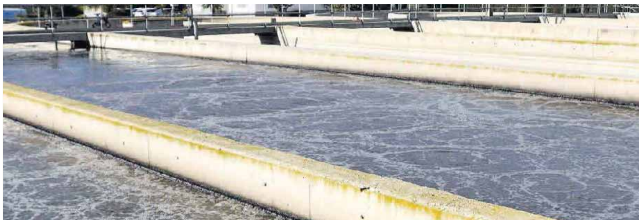
Fase secundaria de la depuración de aguas residuales en la EDAR de Torre Pacheco.
